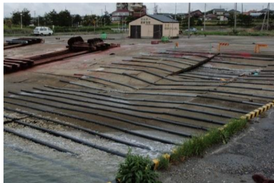
<陥没した飯岡漁港の上架場>
